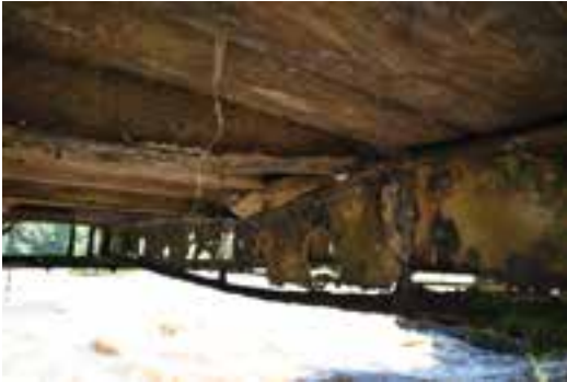
3 Untersicht der bestehenden Brücke mit massiven Korrosionsschäden und plastischen Verformungen © Andreas Galmarini
