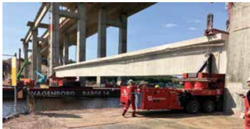
10 Verschub der Träger über Ponton und SPMT in den Vorlandbereich © Moß GmbH
