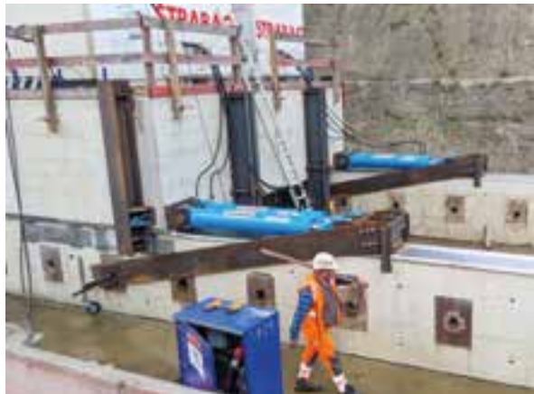
16 Antriebstechnik auf der Verschubbahn © Krebs+Kiefer Ingenieure GmbH
