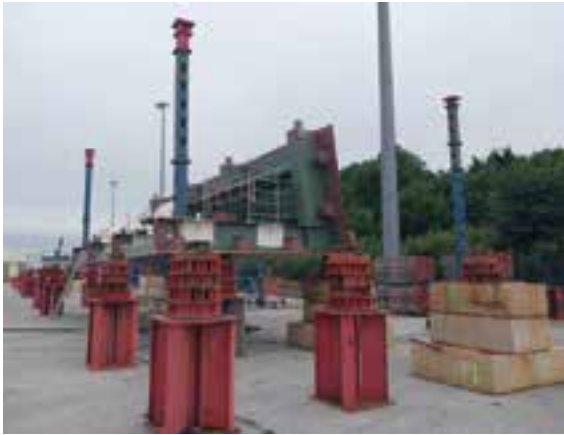
27 Beginn der Vormontage des Mittelsegments im Hafen Rendsburg © Plauen Stahl Technologie GmbH
