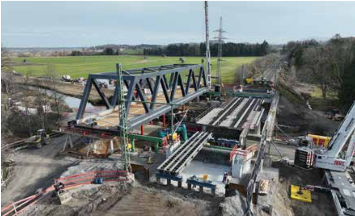
14 Fachwerküberbau kurz vor dem Querverschub © Ing. Hans Bodner Baugesellschaft m.b.H. Co. KG
