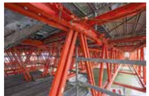
Detaillierte Planung im Vorfeld der Ausführung © Peri Vertrieb Deutschland GmbH & Co. KG
