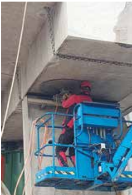
32 Trennen von Stütze und Überbau mittels Wandsäge © BPR Dr. Schäpertöns Consult GmbH & Co. KG
