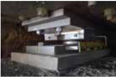
■ Extreme Enge an den unteren Lagern © Maurer SE
