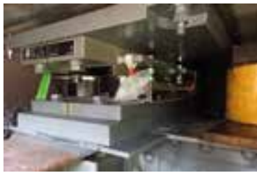
■ Wenig Platz auch bei den oberen Lagern © Maurer SE
