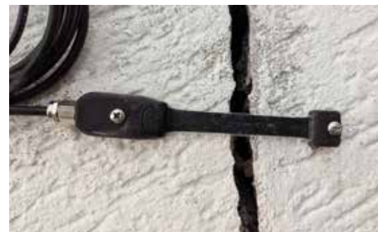
Überwachung von kritischer Infrastruktur © Delfa Systems GmbH
