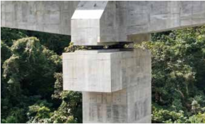
Lager auf einem der Pfeiler © Maurer SE
