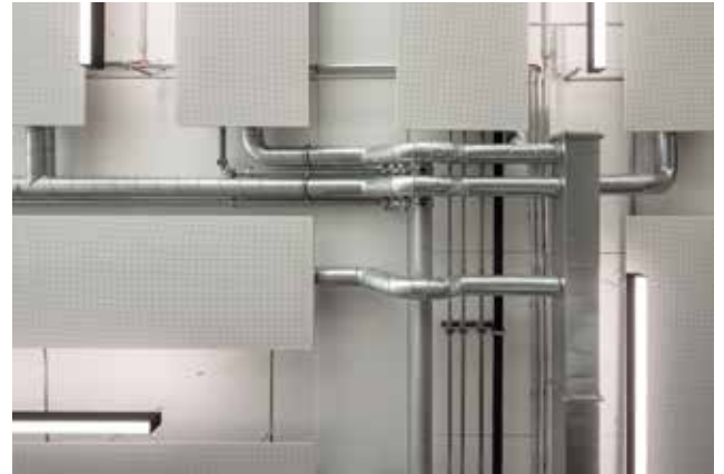
Leitungsführung © HG Esch
