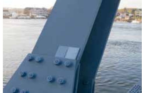
Memorial Bridge: Oberfläche zehn Jahre nach Brückeneröffnung © New Hampshire Department of Transportation
