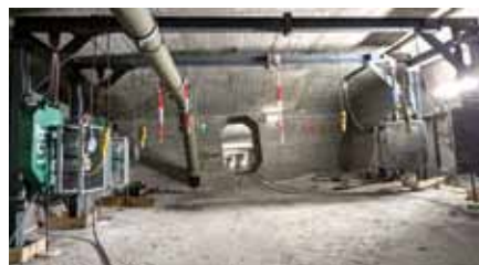
Elektrische Seilwinden im Hohlkasten der Brücke © Maurer SE
