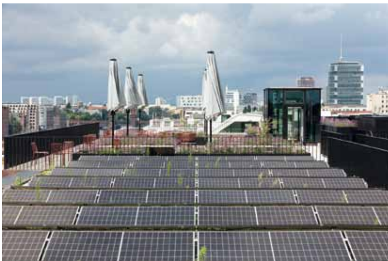
Dachterrasse und Photovoltaikmodule © HG Esch
