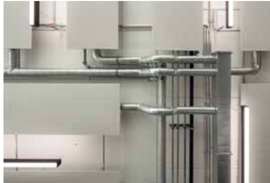
Leitungsführung ... © HG Esch
