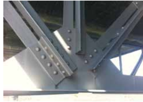
Rombak-Brücke: Korrosionsschutz nach 39 Jahren Betrieb © SINTEF
