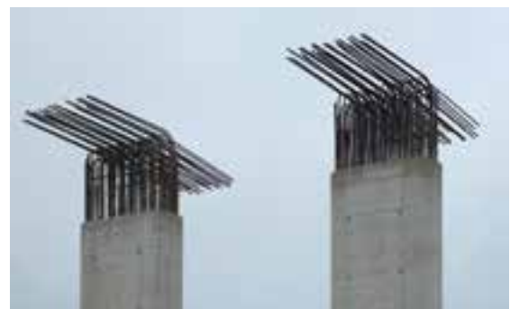
11 Einspannbewehrung am Pfeilerkopf Süd © Kinkel + Partner GmbH
