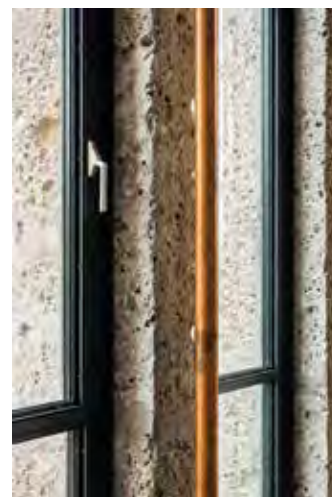
Innenseite mit Begleitheizung aus Kupferrohren © Laura Thiesbrummel/Jansen AG
